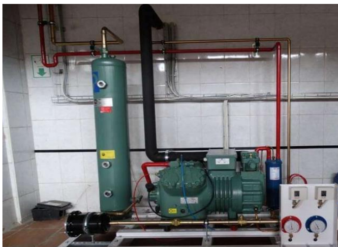
Рисунок 1 – Результат комплексной наладки холодильного оборудования. Общий вид. [4]
