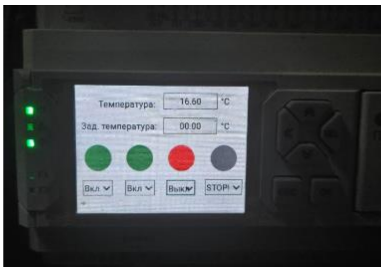
Рисунок 96 – Запуск устройств 2 секции
