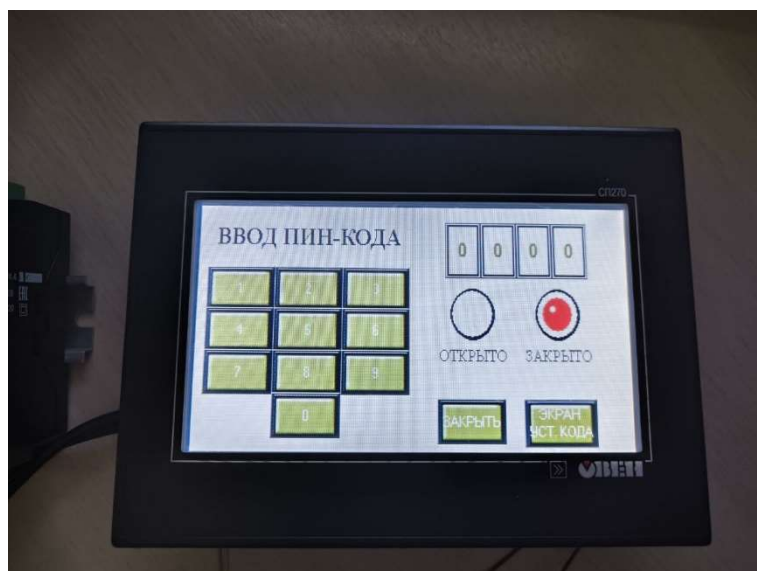
Рисунок 113 – Экран панели оператора после перевода замка в состояние «Закрыто»
