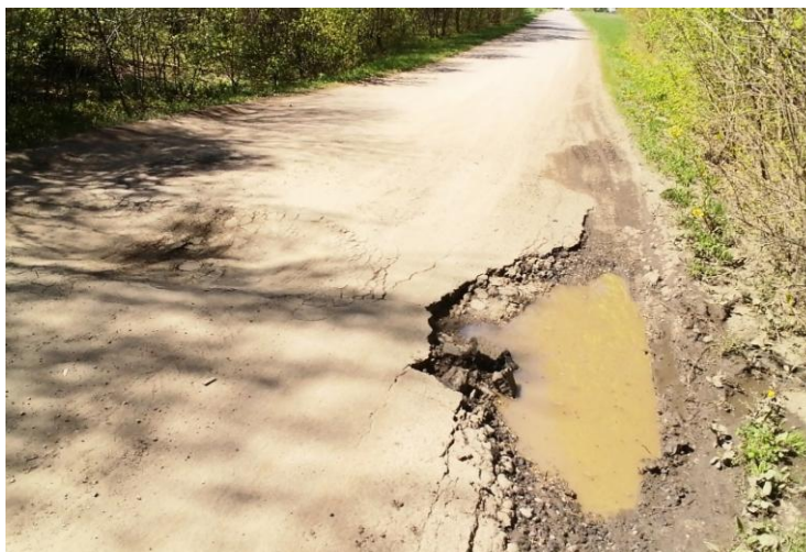
Рисунок 28 – Состояние дорожного покрытия
