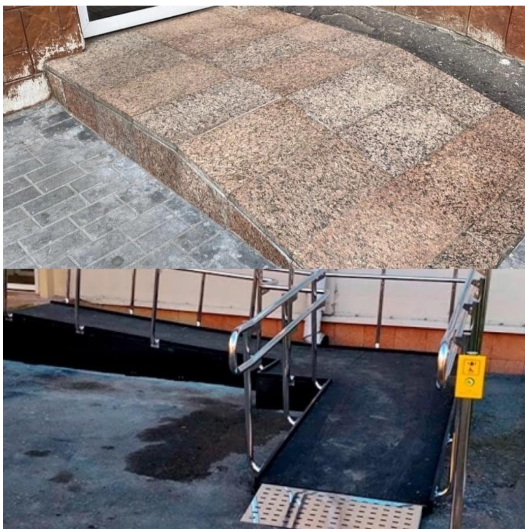
Рисунок 37 – Состояние пандуса в отеле/как должен выглядеть пандус для обслуживания людей с инвалидностью
