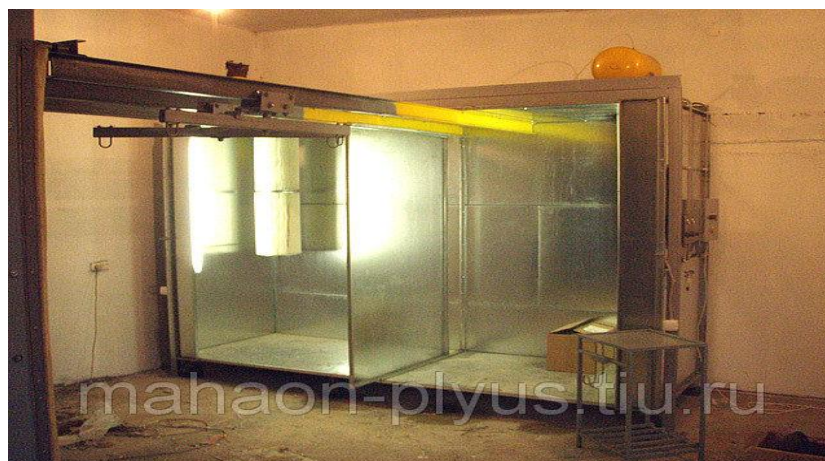
Рисунок 2.8 - Камера порошковой окраски
