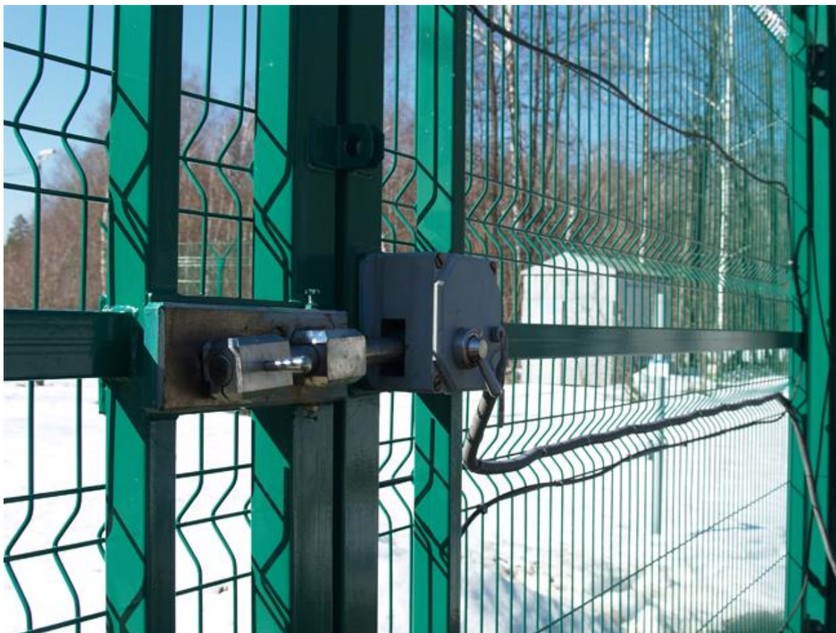
Рисунок 1.10 – Запирающее устройство, установленное на воротное ограждение.
