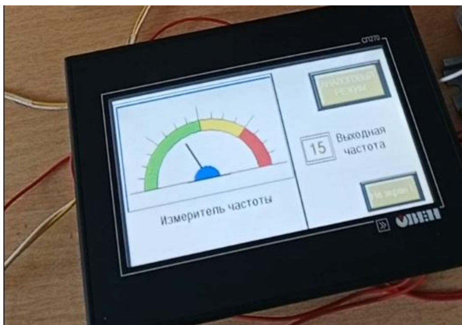
Рисунок 112 – Измеритель частоты при работающем вентиляторе
