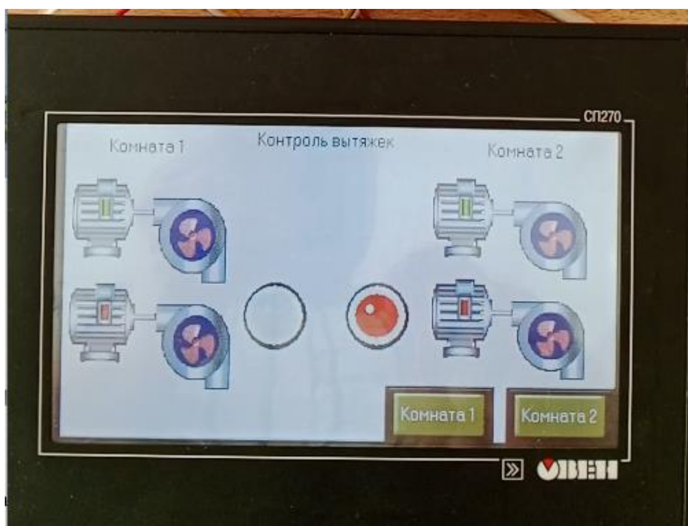
Рисунок 89 – Работа одной из вытяжек в Комнате 2
