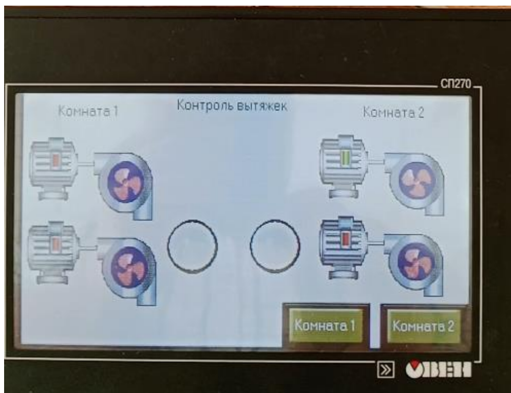
Рисунок 93– Работа одной вытяжки в Комнате 2
