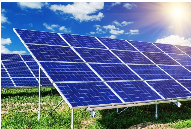
Рисунок 13 – Солнечная электростанция (СЭС)
