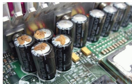
Рисунок 3 – Высохшие электролитические конденсаторы
